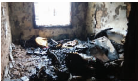
南侧的卧室被烧空
