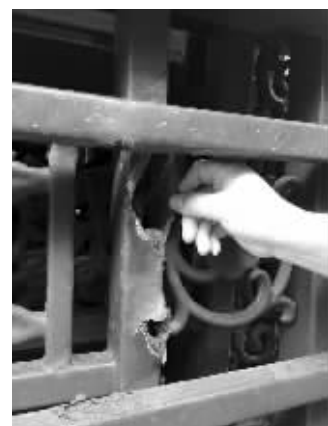
更换前破旧不堪的大门
