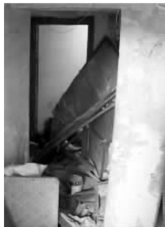
爆燃产生的冲击力致使地下室大门扭曲变形 报料人供图
