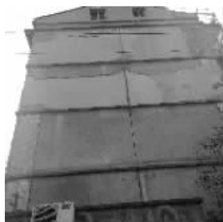
外墙水泥大面积脱落
