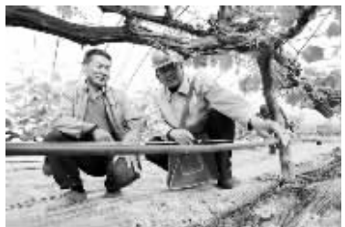
区供电公司积极服务果蔬产业发展,承诺:果蔬种到哪里,供电服务就跟到哪里。图为4月23日,该公司小纪供电所员工为义发葡萄园检查电力灌溉装置。 任飞 王正华
