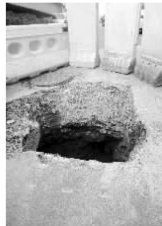
路面上的塌陷 现代快报记者 孙玉春 摄
