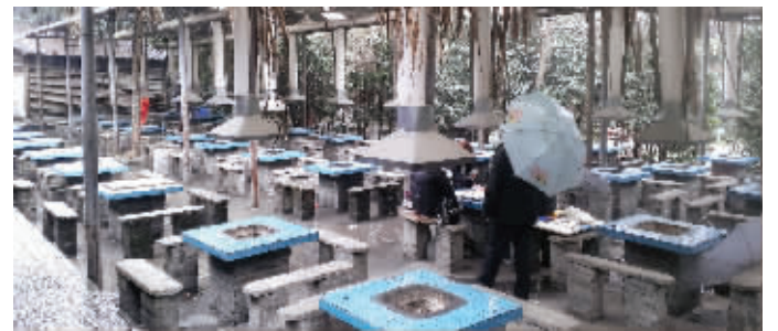
古林公园的烧烤场安装了吸烟罩
