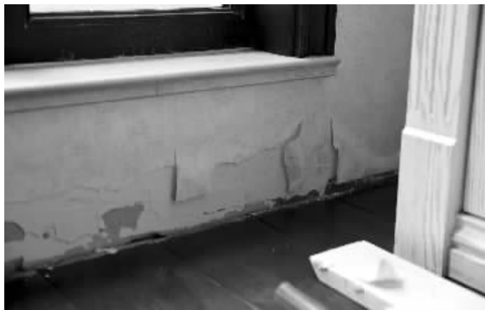
墙面受潮,墙纸泡得一塌糊涂
