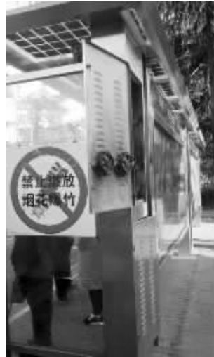
公交站台,配电柜柜门大敞着 网友图片
