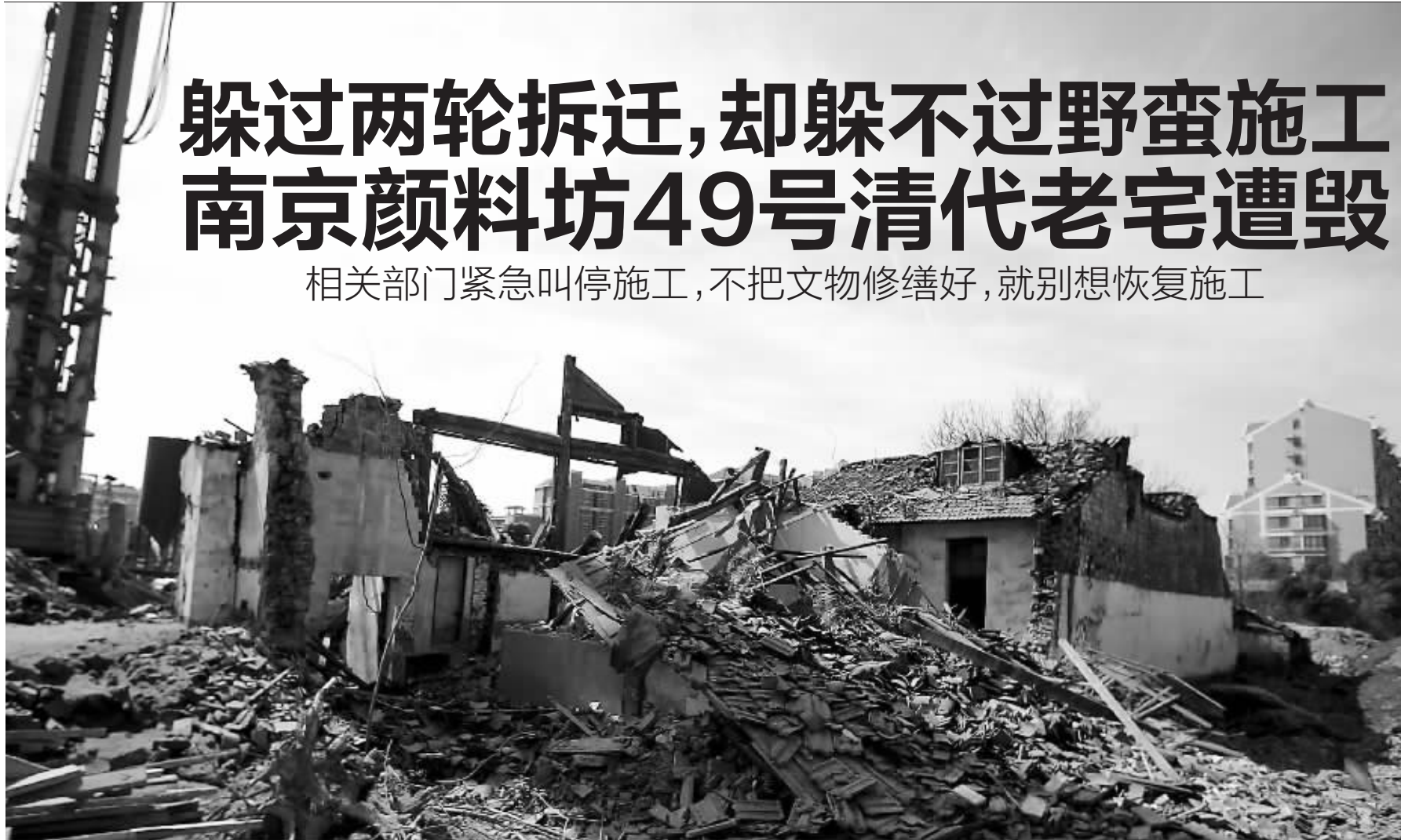
颜料坊49号的大门已经不在, 南侧的墙体也不见了
