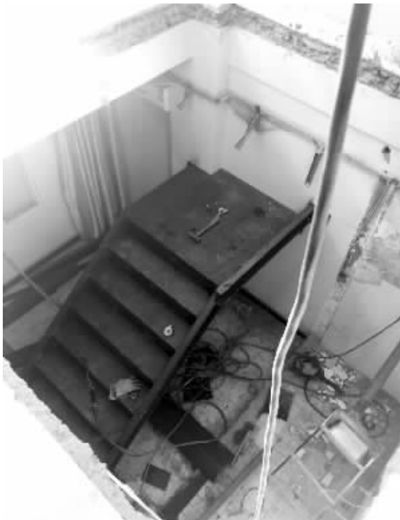
三楼以上的部分楼板被砸穿 现代快报记者 廖健伟 摄
