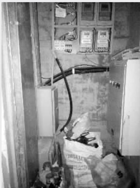
电梯间里堆着很多杂物
