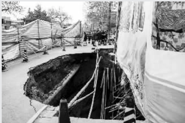
路面坍塌时的场景 CFP供图
