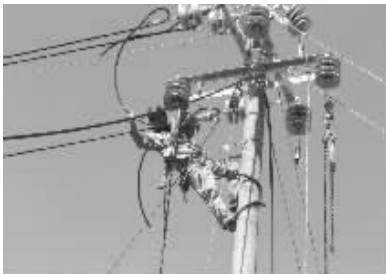
为全面解决农村地区低电压、卡脖子等问题,丰县供电公司组织施工队伍对重点地区进行线路改造,确保春节前送电投运。 常敬波
