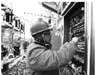
为确保春节期间安全供电,大丰供电公司对本辖区内的供电线路及设备进行巡视维护,以确保电网安全稳定运行。 唐建军
