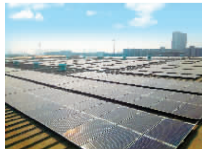
亚玛顿的屋顶太阳能电站
