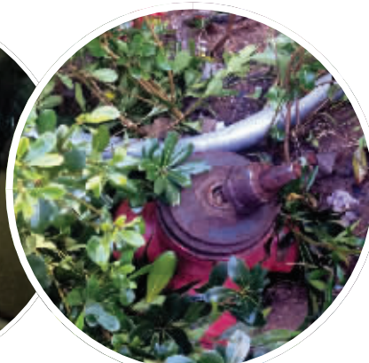
被撞坏的消防栓
