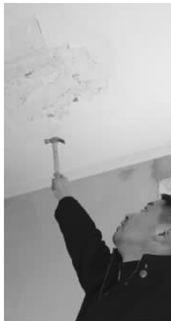
新房的楼顶漏水
