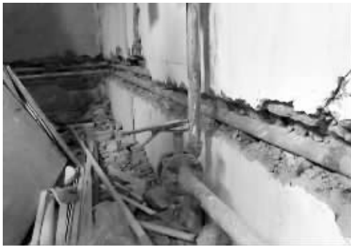
偷埋的天然气管道 通讯员 遇见 供图
