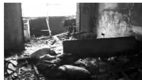
主卧室家当被烧光,爆炸的电瓶就在阳台上
