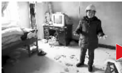
修路造成她家房顶瓦片脱落、墙体开裂
