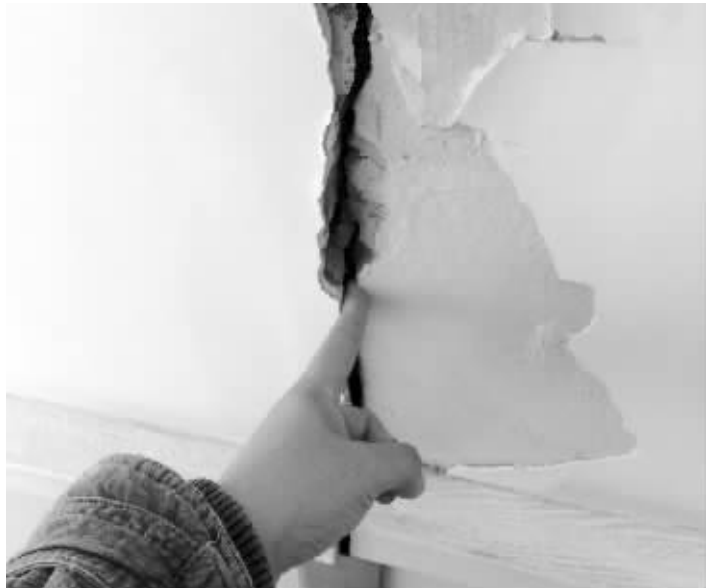
裂缝最宽处能塞进一节手指
