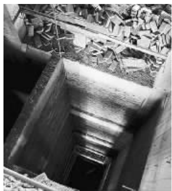
在建电梯井坠亡意外,时有发生(资料图片)
