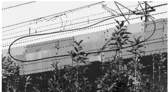
有的地铁高架护栏板已经翘起 现代快报记者 徐洋 摄
