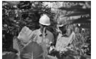
11月30日,兴化供电职工为梦水乡鲜花种植基地更换老化线路,调试恒温用电设备,全力确保花卉种植户用电无忧。 申祝存
