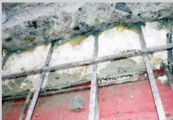
从整个断面来看,钢筋与混凝土几乎处于分离状态
