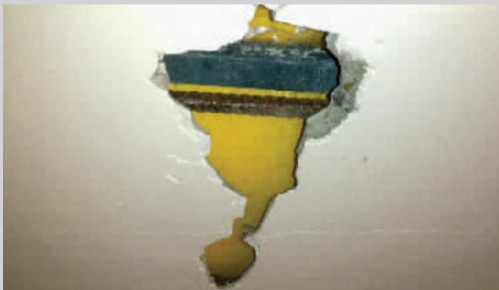
从裂开的天花板中,可以看到锈蚀的钢筋以及黄色塑料包裹的泡沫板
