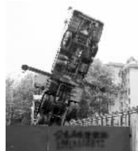
去年吊车侧翻时的照片
