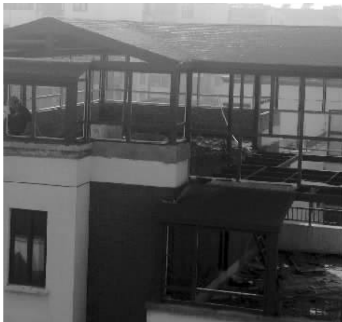
楼顶搭建的钢结构违建,面积约92平方米
