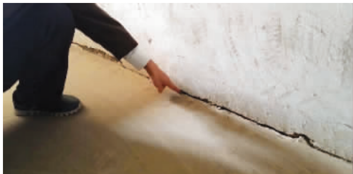
车库的裂缝可以伸进一个食指
