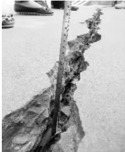
车库入口处的裂缝大得吓人
