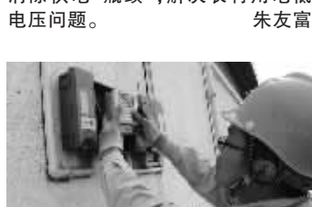
11月7日,许庄供电所分组对线损不合格台区进行突击检查,开展线损超标台区整治,对故障表计适时进行更换,有效提升线损管理水平。 陈勇 穆长杉
