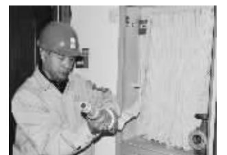
11月3日,邳州市供电公司消防安全检查人员到该公司办公楼消防管道进行仔细检查,全力确保秋冬季消防安全。 曹庆升
