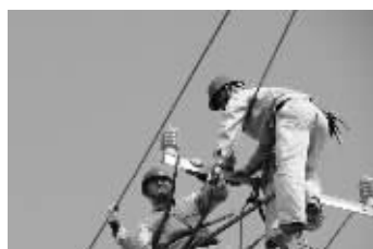
11月10日,睢宁县供电公司推进古邳镇低压线路改造工程进度,消除供电“瓶颈”,解决农村用电低电压问题。 朱友富
