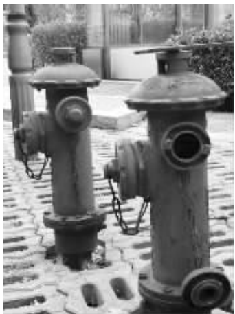
锈迹斑斑的消防栓一滴水都放不出来
