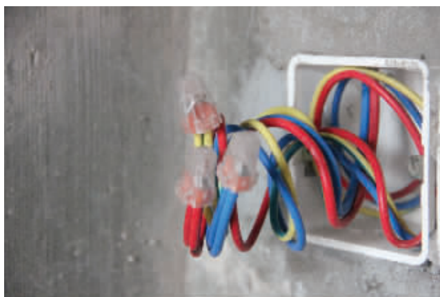
插座必须使用接线端子，厨房卫生间主进线单放4 2 mm线
