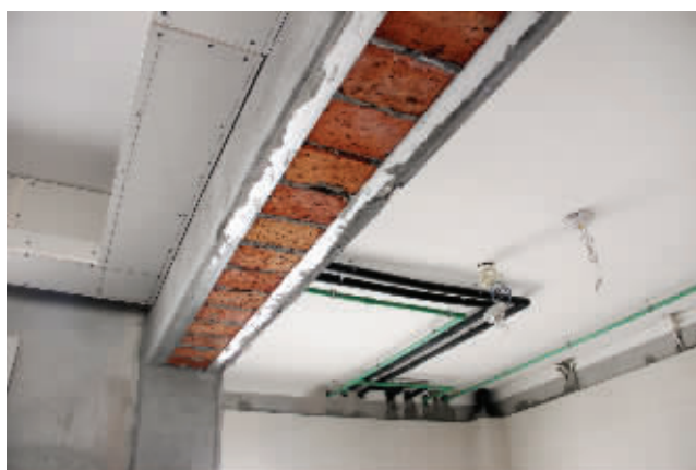
新砌门头必须使用镀锌角铁，与墙体连接不得少于10厘米，确保不会因为门头下沉造成门闭合不畅
