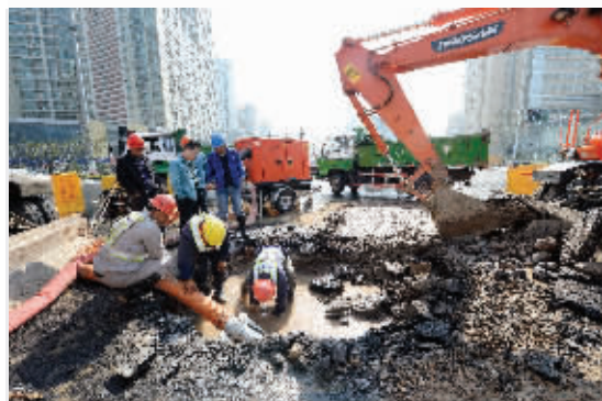
南京定淮门大街与江东北路交叉口水管破裂,工作人员正在抢修 现代快报记者 施向辉 摄
