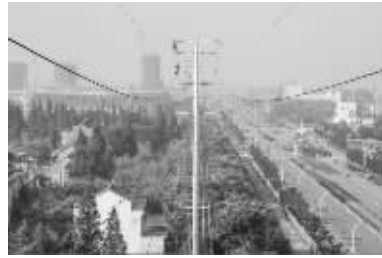
连日来,泰兴市供电公司抓住秋季施工的黄金季节,加快辖区内电网建设改造步伐。图为10月22日,泰兴市供电公司员工在该市北三环路对110千伏徐济徐北线进行线路改造作业。
