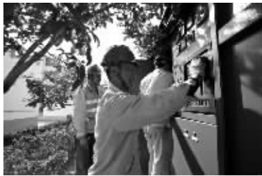
10月28日,姜堰供电公司施工人员在姜堰区光明东村进行小区变压器低压开关调试工作。此次改造工程惠及居民和商户3200多户。
