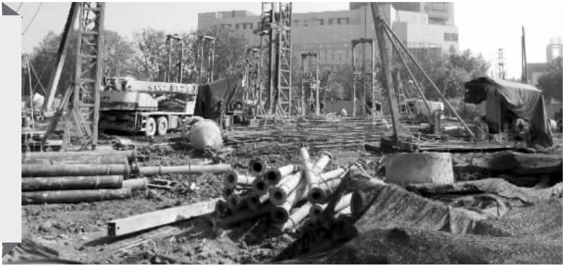
10月24日, 南京证大大拇指广场桩基工程, 现场没有完全覆盖 现代快报记者 马晶晶 摄
