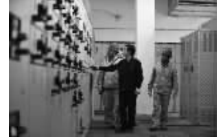
沛县供电受地方主流媒体关注配图:沛县供电公司为企业进行安全用电检查
