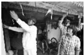
10月17日,姜堰蒋垛供电所工作人员在姜堰蒋垛镇蒋垛村贫困户王裕家中帮助办理每月减免15度电费登记手续,帮助他们将家里的用电线路、日常照明设施等用电设备进行更换维修,受到当地群众的欢迎和赞扬。 李杨摄文
