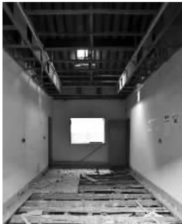
花露岗53号老建筑里地板损坏
