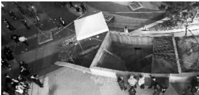
10月17日，在韩国京畿道城南市，救援人员在地铁通风口坍塌事故现场忙碌。新华社/美联
