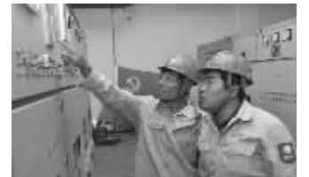
党员服务队队员检查中宇光伏用电负荷情况。
