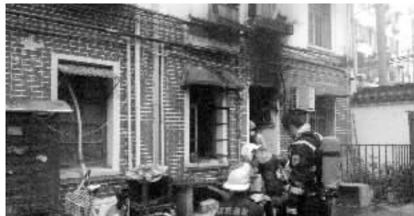
失火的居民楼墙壁被熏黑了
