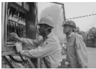
为保障中秋节日期间市民安全可靠用电,泰兴市供电公司制定节日保电应急预案,合理安排电网运行方式,并对辖区内各变电站设备、重要线路等进行全面隐患排查,确保设备线路安全运行。图为9月8日,泰兴市供电公司工作人员正在对姚王镇毛庄村配电台区进行隐患排查。
