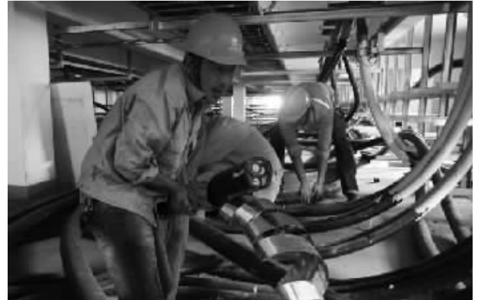
9月10日,泰州供电公司电缆施工人员来到泰州市区政府重点工程——鹏欣领誉安置区,对10kV配电房进线电缆实施安装调试,敷设YJV22400电缆12根计3600米,工程比原计划提前10天完成。
