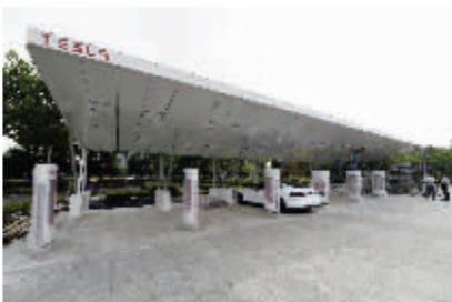
软件大道路边的超级充电站
