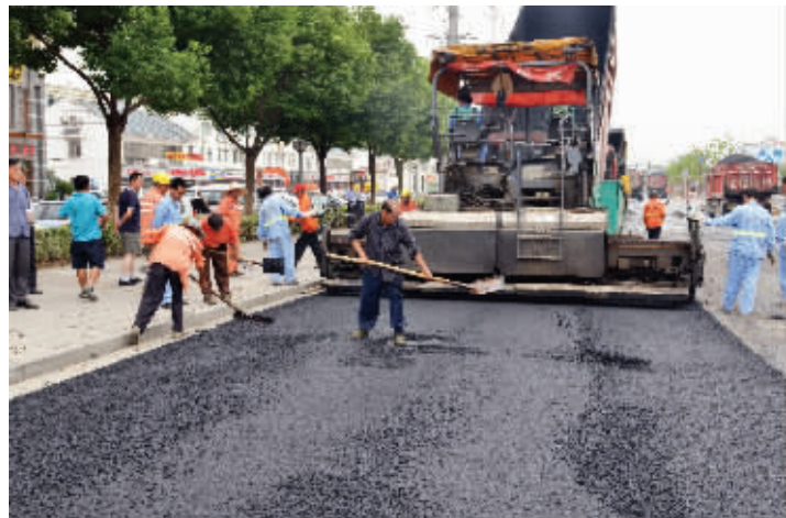
施工人员正在地铁2号线荣巷站周边路面摊铺沥青 滨湖城管供图
