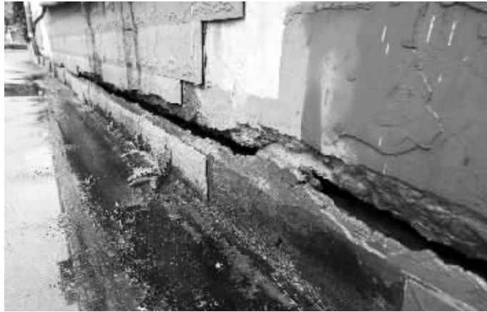
开裂部分位于墙体底部,缝隙在10厘米左右
