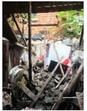
屋顶坍塌,余大爷家一片狼藉
