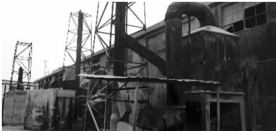
彩天公司的锅炉
