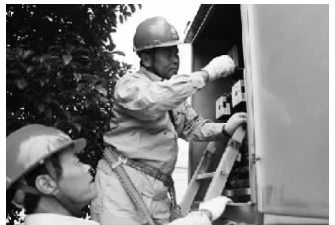
8月18日上午,靖江市供电公司员工对江苏大雨科技公司的配电柜进行“体检”,试跳漏电保护器,确保企业用电正常可靠。汪红清
