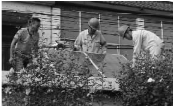
8月20日17时05分,铜山供电公司柳泉镇前停村村民张才启投资的光伏发电设备完成了电表安装等相关手续,开始并网售电。这是铜山第三户投资光伏发电,并完成并网售电的村民。邵迎进 王庆标
