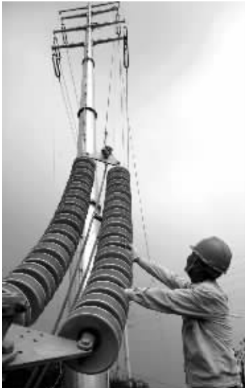
8月21日,泰州供电公司电力工人冒着高温对220千伏洋思变至丹天变双回路线路进行改造,以提高泰兴市丹天化工企业的供电能力。图为:电力工人正在悬挂耐张绝缘子。
