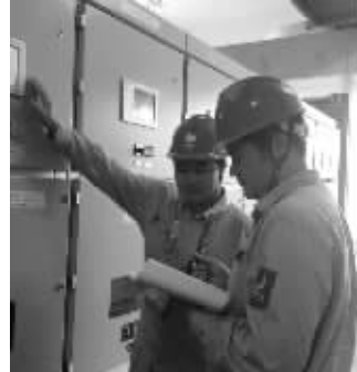
陈骞(右)在南京青奥会供电保障现场 姜振军 摄
